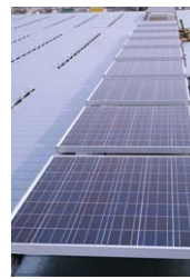
屋根の上に設置された太陽光パネル
