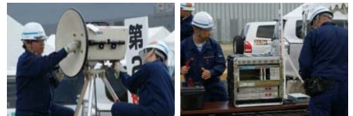
無線と簡易中継装置による回線提供
